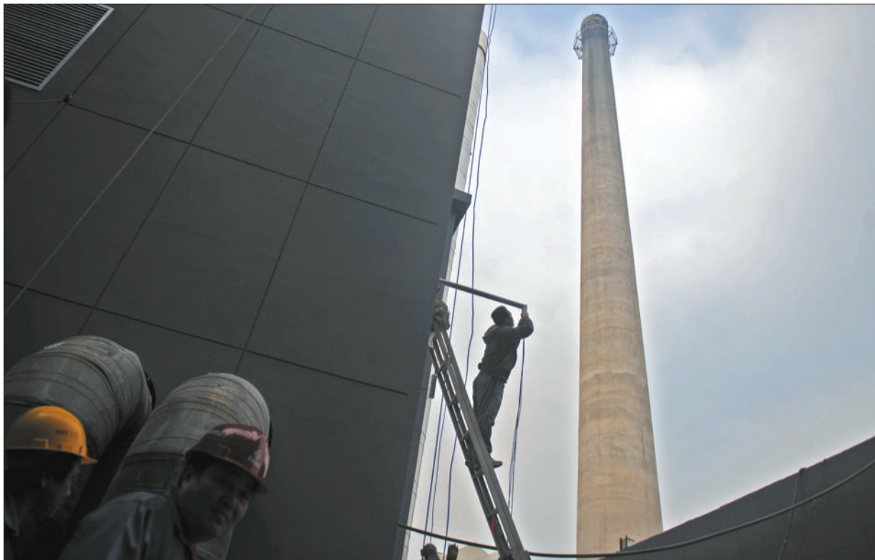
2011年11月15日,马连道一处锅炉供热点,工人们正在为旁边新建的天然气的锅炉布线。 本报资料图片 本报记者 杨杰 摄
