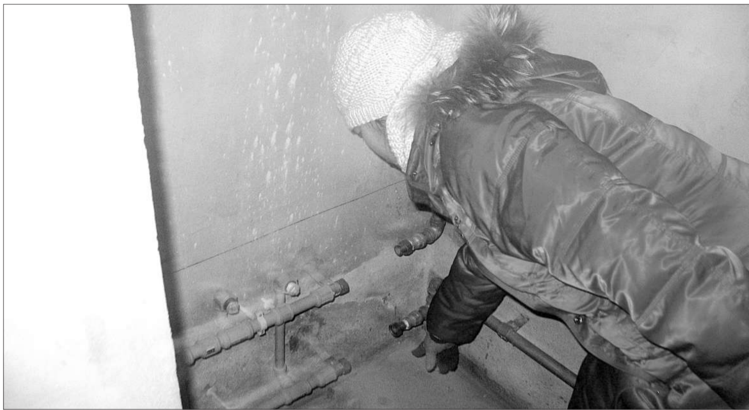
业主在查看水管。近日,丰台南宫景苑小区的限价房收房后发现,屋内没有通水供暖。
