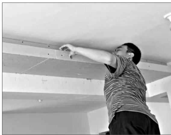
新年后复工前需要重点检查的是吊顶、隔断接缝处。
