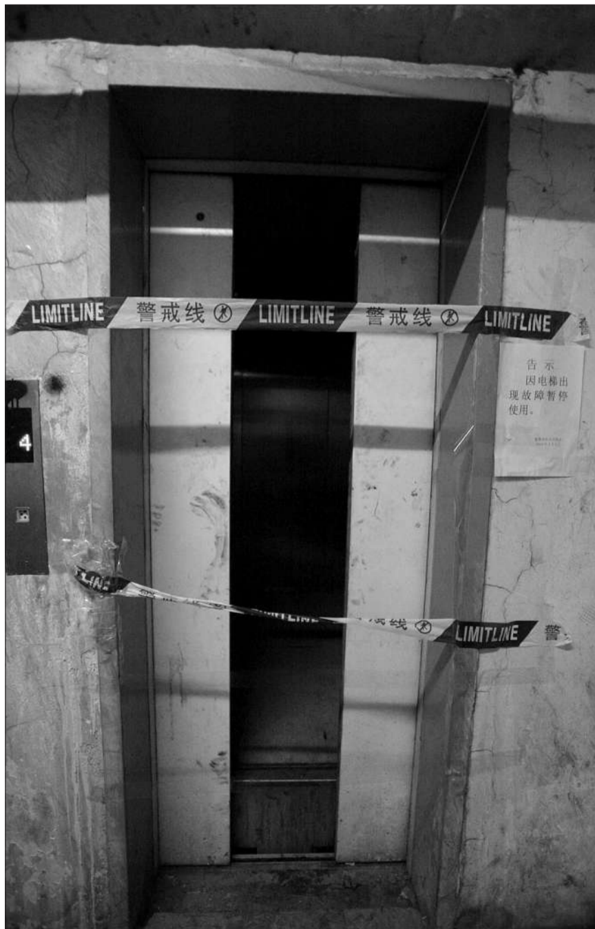
前日,富莱茵花园小区11号楼地下一层,电梯门半开,电梯被贴了警示条。当天下午,该电梯突发故障,从四楼坠至地下一层,导致多人受伤。 本报记者 王嘉宁 摄
