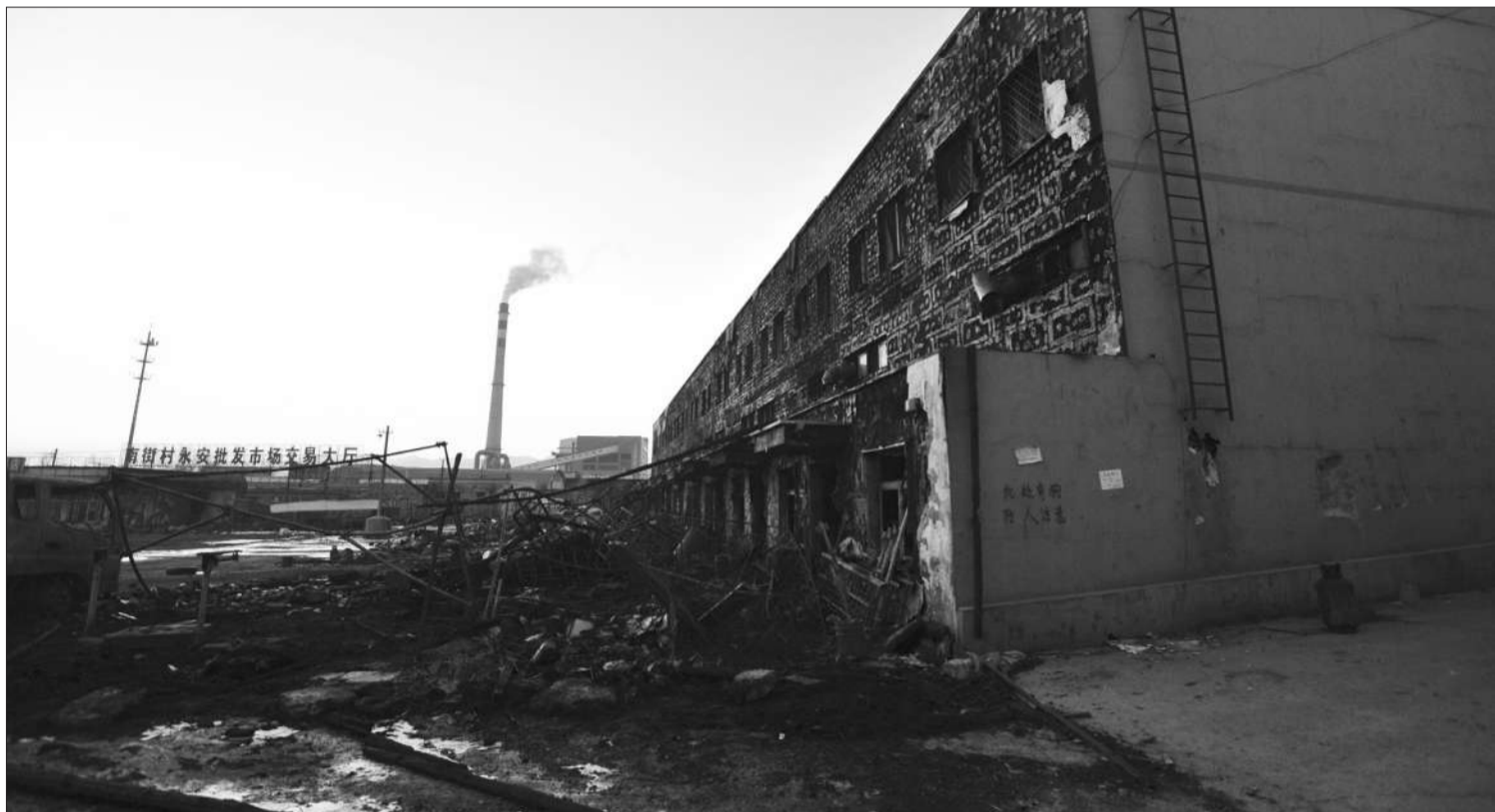
昨日,永安批发市场火灾现场,一栋三层楼西南侧外墙脱落,楼前水果棚已被烧毁。
