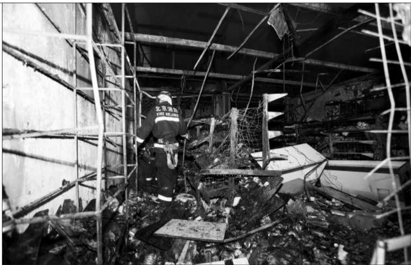
着火的超市内,货架烧变形,只剩下一些铁架子。
