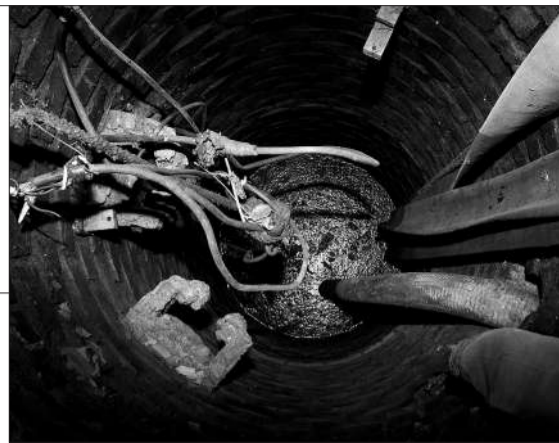
总提升井井下三米处,是通过化粪池沉淀后的粪水,这些粪水会通过消防水带流入雨水井。
