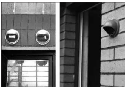
厨房排烟使用水平直排系统,外墙风帽向外倾斜防雨水渗入。
