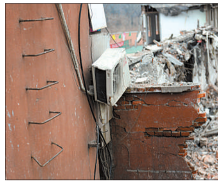
一尚未搬走的居民屋外空调已受损。
