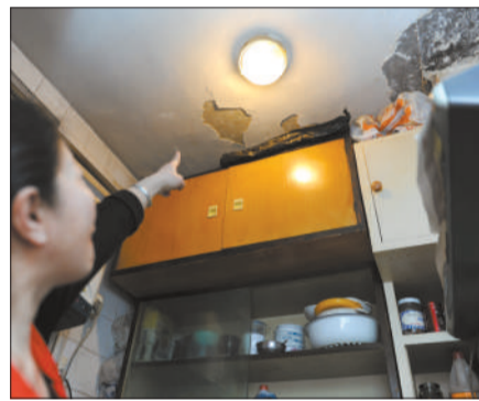
校区内一居民家中房顶受损、漏水。
