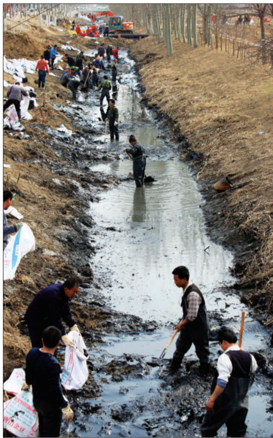
昨日，泄漏的原油浮在于家务村东口的河道中，工作人员正在将受污染的土壤装袋。
