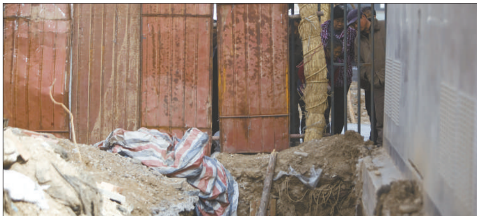
昨日,丰台区小屯西路,事发现场可见一个3米多深、1.5米宽的深坑,周围有群众正在围观。当日,该配电室基座的外立面突然掉落,将正在基座下进行电缆作业的几名工人掩埋,致2死2伤。本报记者 周岗峰 摄
