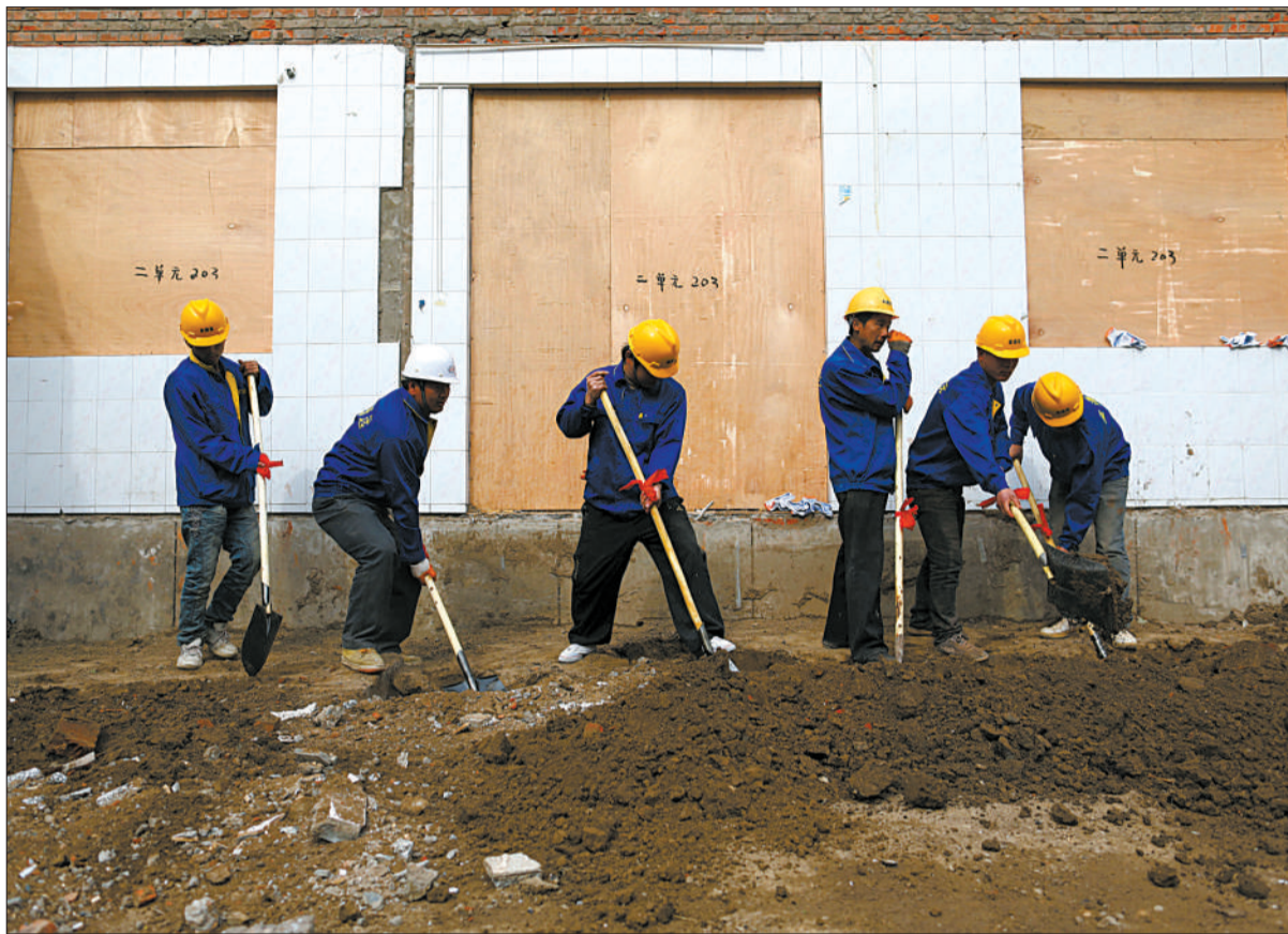
4月1日,朝阳区新源里西11号楼,施工人员挖掘地面准备打桩。全市首个老旧小区改造工程破土动工。
