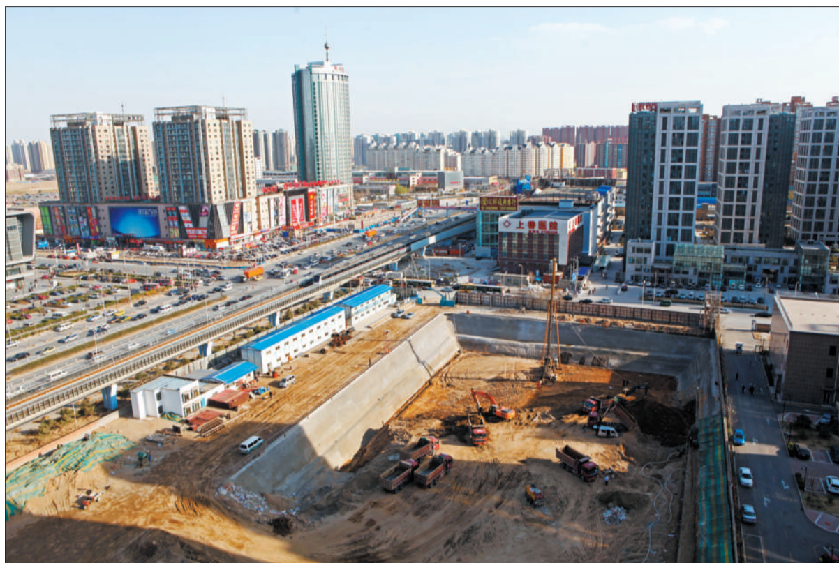
昨日,四级大风,天通苑正辰小区附近一工地,“顶风”运土,扬尘严重,给附近居民生活带来困扰。 本报记者 秦斌 摄
