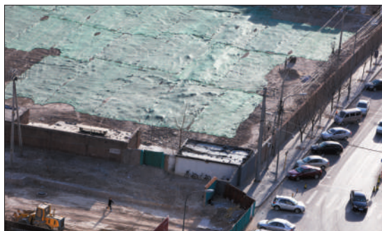
昨日,北五环外双营路,一施工的工地被盖上了防尘罩。 本报记者 秦斌 摄
