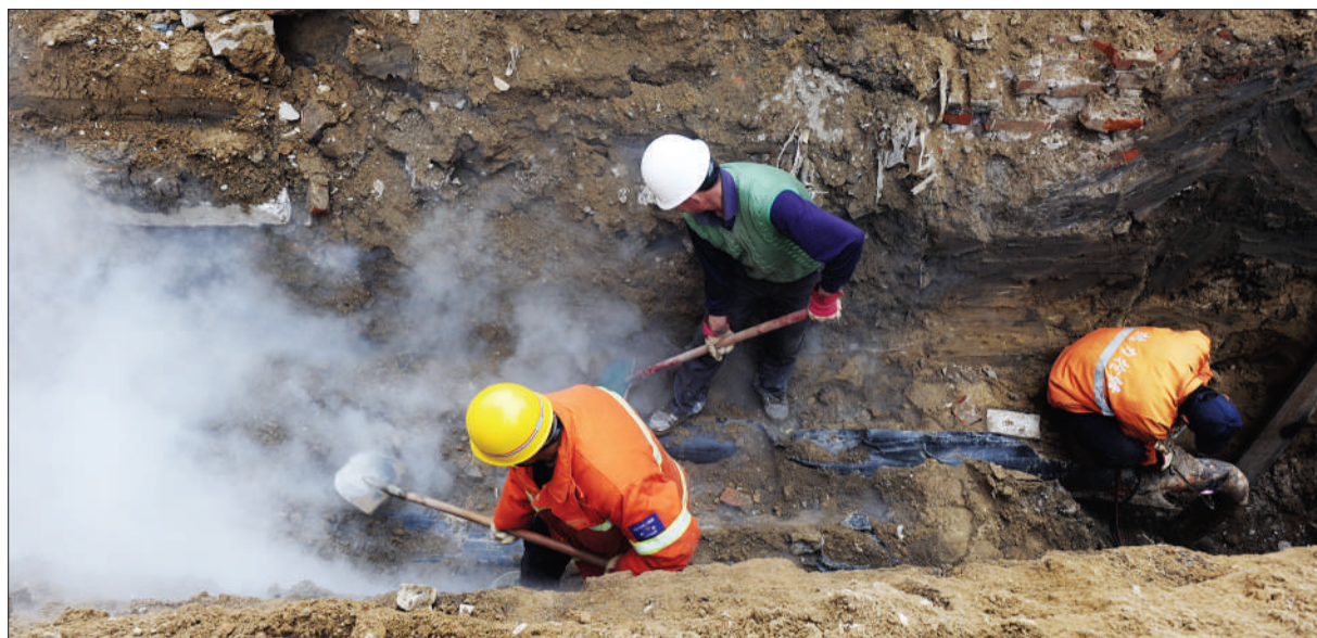
4月2日,事故发生后,工人们在事故现场抢修热力管。
