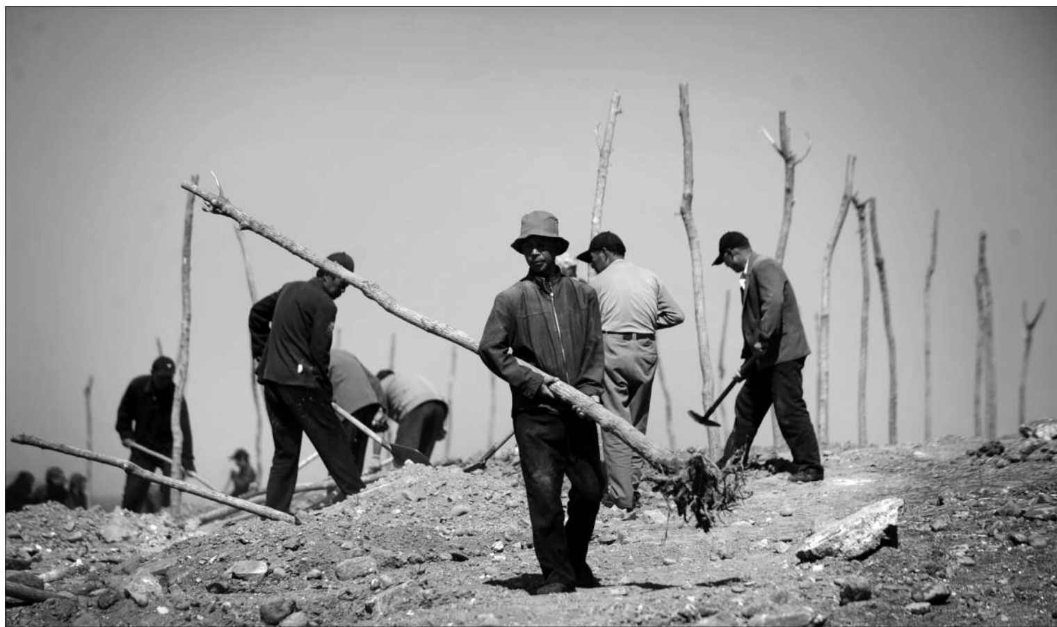
昨日,丰台长辛店镇药用植物园,工人们正在栽树。长辛店镇药用植物园占地300亩,植树面积达到近60%,力争4月底前完成植树。 新京报记者 尹亚飞 摄
