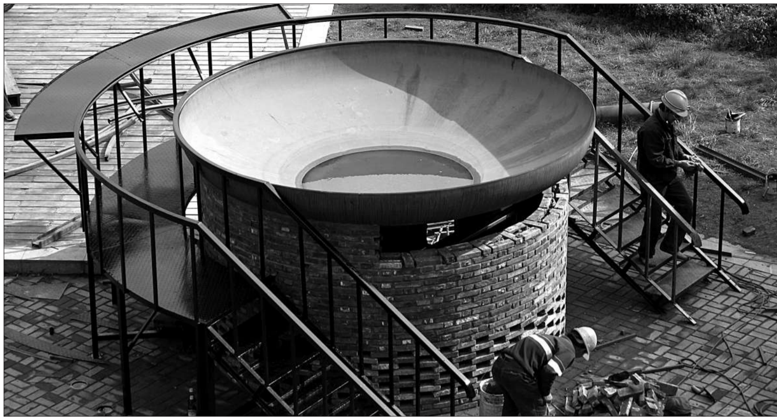
南通建“世界第一大锅” 昨日,江苏南通的工人们正忙碌着为“世界第一大锅”搭建灶台。日前,一口直径3.5米,厚度1.2厘米,深度76厘米的特大铁锅铸造完毕,运抵南通江海美食节活动举办地——狼山风景区园博园景区内。 朱吉鹏 摄
