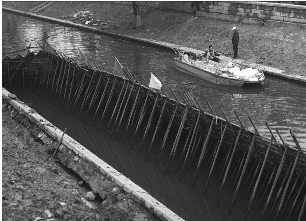
昨日,国家图书馆地铁站西南侧长河河段一侧河岸,施工人员正在维修。
