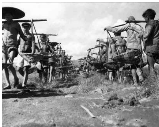
大量的劳工队伍在建设腾冲机场的工地上运载泥土。工兵的机械设备通过一条连接列多公路的路运到这个机场,机场很快就修建起来了。
