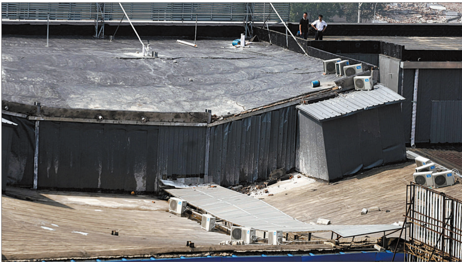
昨日,从高处看,丰台区宋家庄地铁站附近,融家快捷连锁酒店顶部可见凹陷痕迹。该酒店所在建筑的6至8层塌陷,140余名房客逃生。 新京报记者 王贵彬 摄
