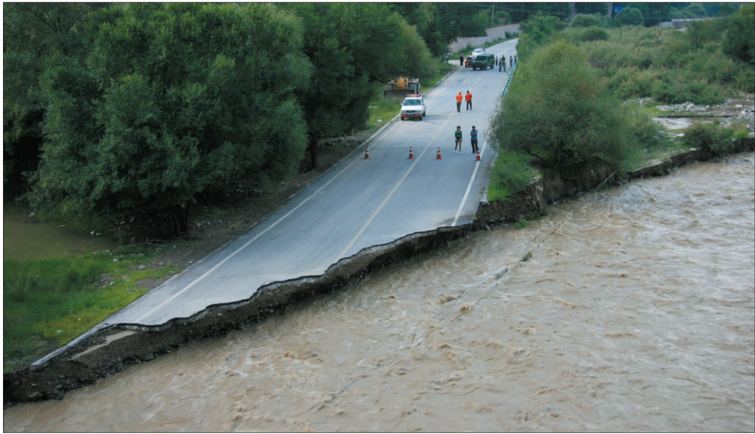
7月28日，新疆和静县218国道巴伦台段被洪水冲毁。当日，受持续降雨影响，新疆和静县境内218国道部分路段被冲毁，2000多名游客滞留。新华社发
