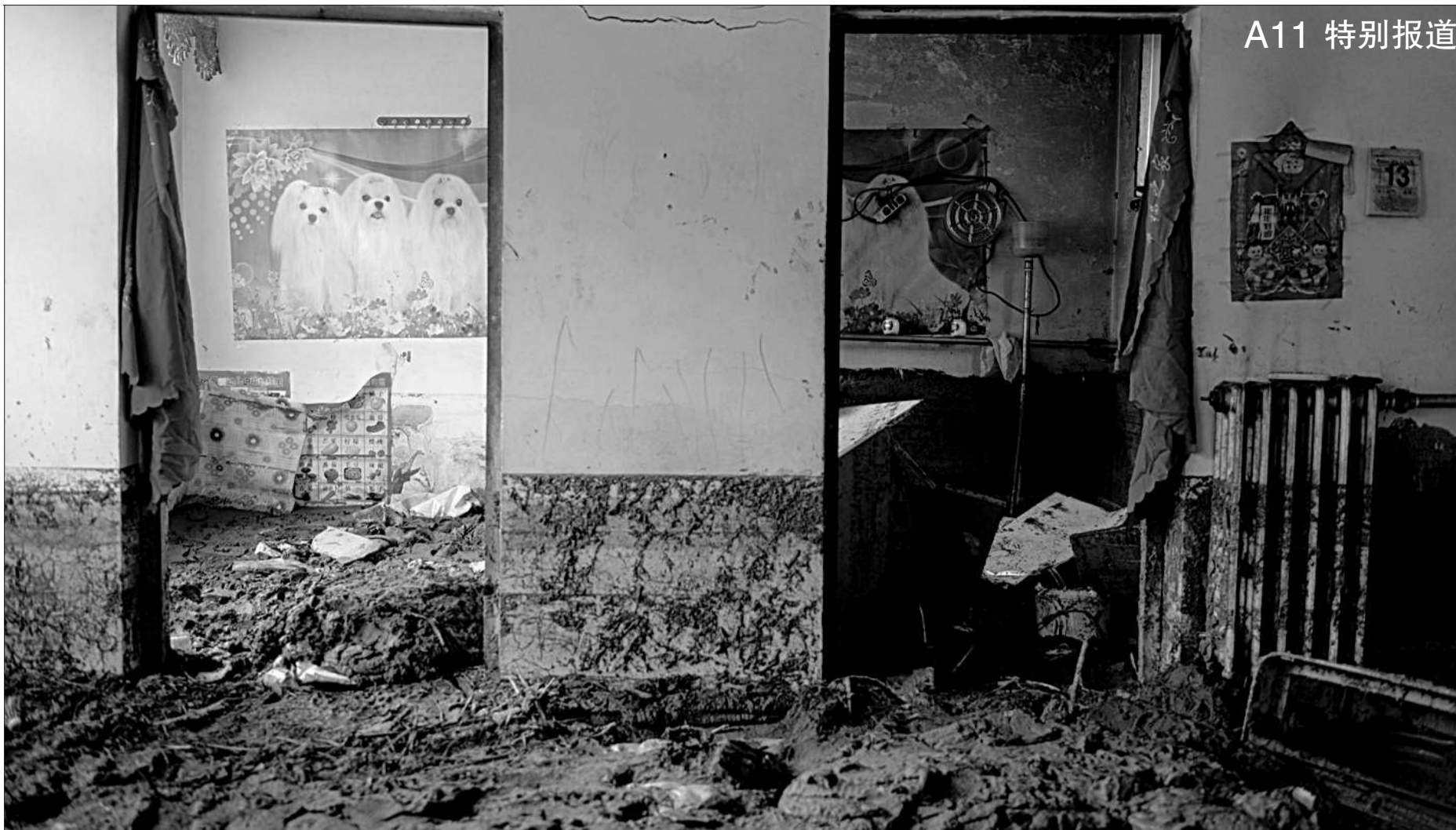
8月1日,涑源县王安镇小沟村,泥石流冲进村民家里。
