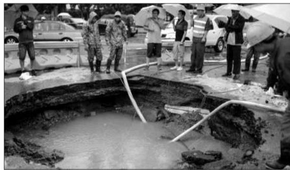
昨日,朝阳区花家地一路口出现路面塌陷。
