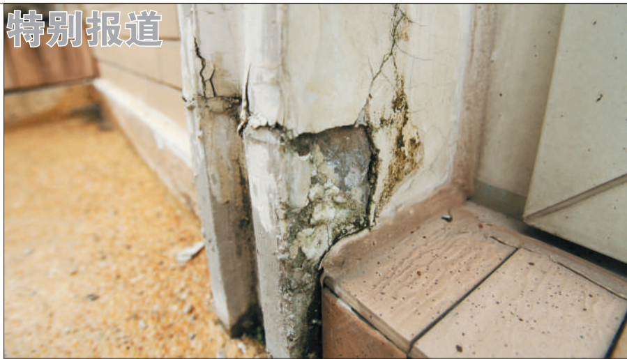
一些阳台的墙体因漏水而腐坏,平时要及时处理这些角落。
