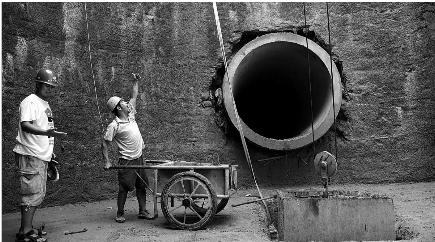
昨日,新发地批发市场东门,西南热电中心燃气输气隧道,工作人员正在现场施工。
