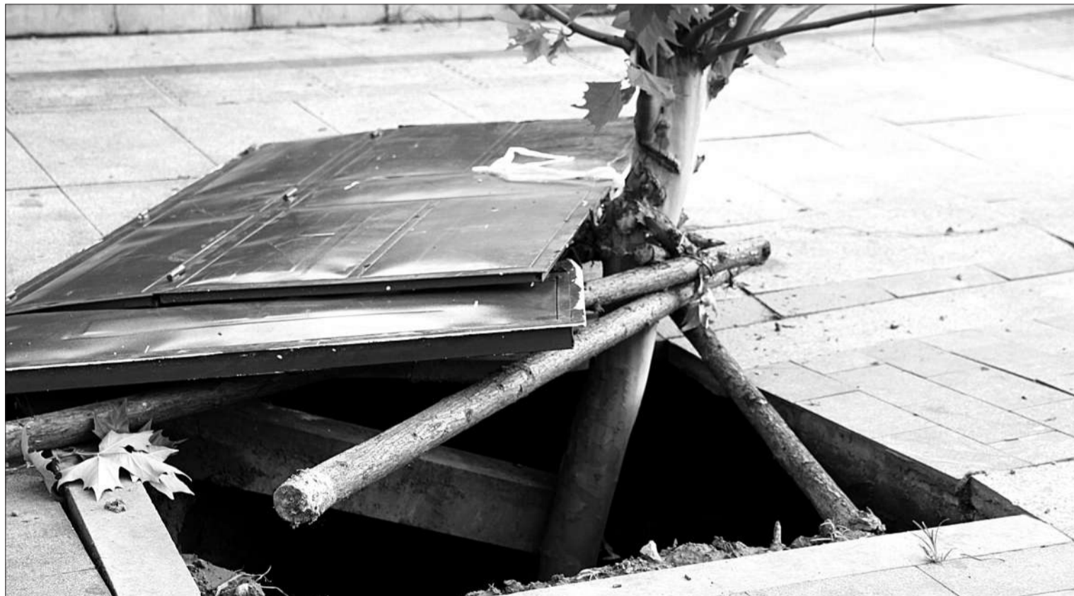
昨日,朝阳区景闻街西口便道发生塌陷,一棵小树陷入沉降的地面里,所幸无人员伤亡。
