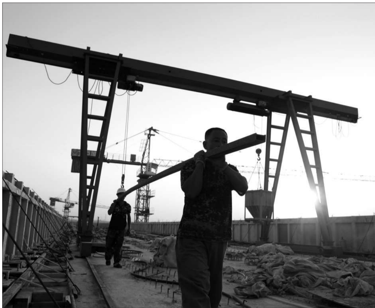
昨日,14号线横跨永定河的最后一段桥梁开始浇筑。至下午,14号线跨永定河特大桥贯通,主体全部完工。
