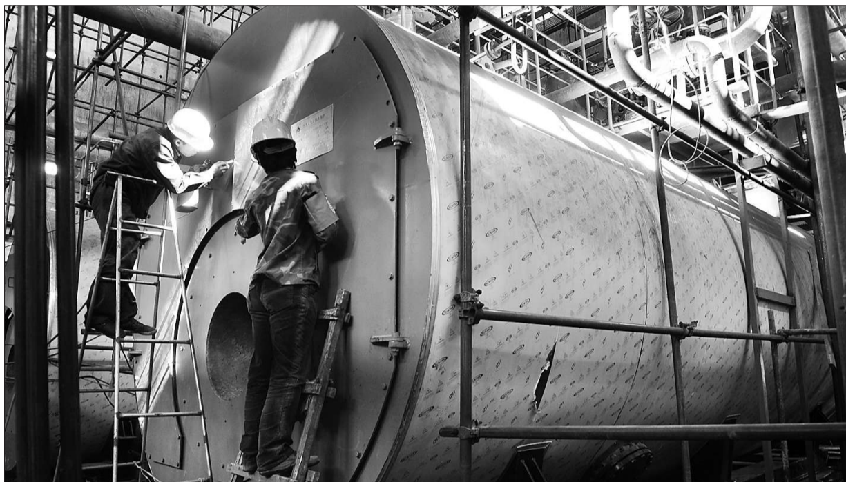
昨日,位于望京花家地的东郊供热厂,工人们正在安装燃气热水锅炉。
