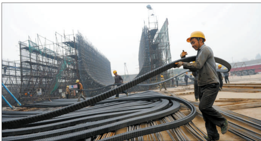
21日,河南平顶山,中国水电四局工作人员在南水北调中线沙河渡槽工程工区施工。蓝山 摄
